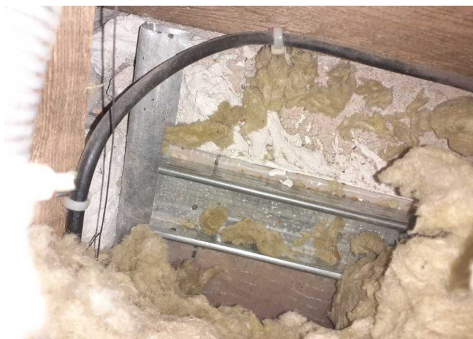
Foto /11/ Pohled do sondy na napojení SDK podhledu s parotěsnicí PE fólií na vnitřní stěnu
