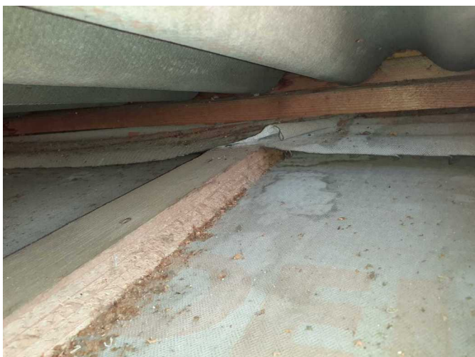
Foto 7/ Stopy po lokálním zatékání na svrchním povrchu pojistné hydroizolace v místě sondy
