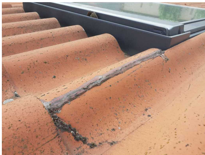
Foto /16/ Degradace střešní vlnité krytiny
