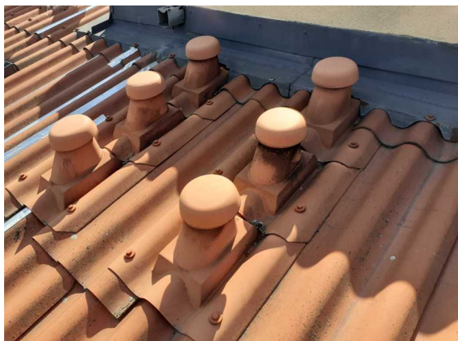
Foto /23/ Komínky odvětrání kanalizace
