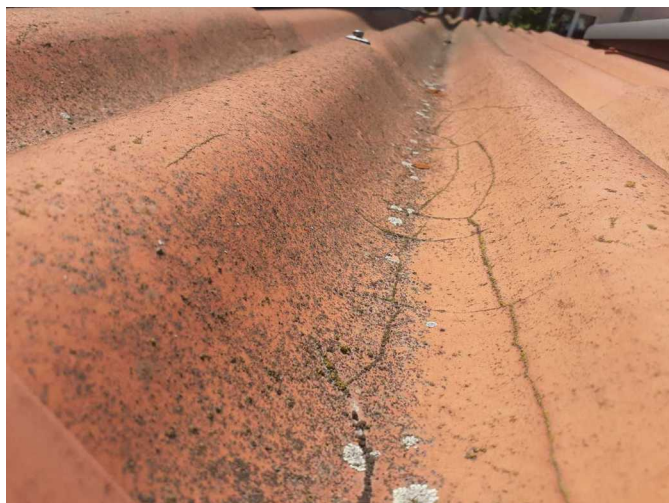
Foto /15/ Degradace střešní vlnité krytiny
