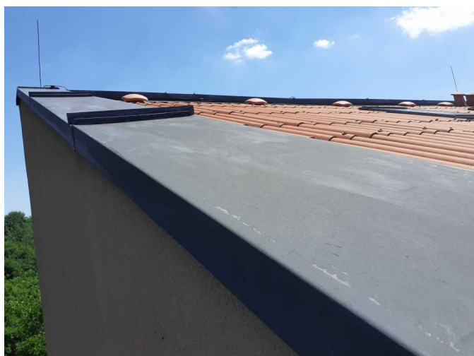
Foto /13/ Vnější okraj střechy v oblasti štítu
