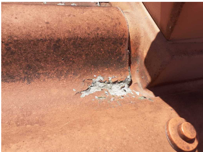
Foto /7/ Degradace střešní vlnité krytiny
