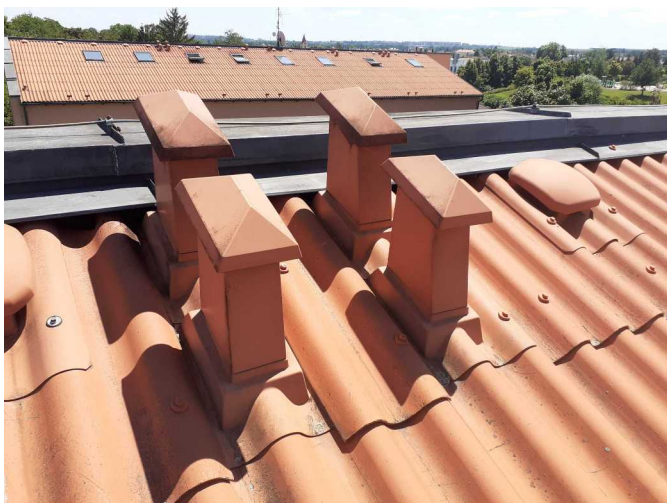
Foto /15/ Komínky odvětrání kanalizace
