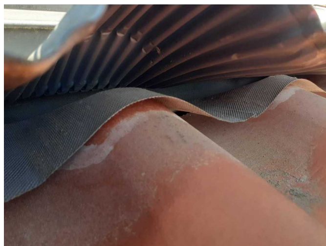
Foto /20/ Pohled pod spodní lemování střešního okna
