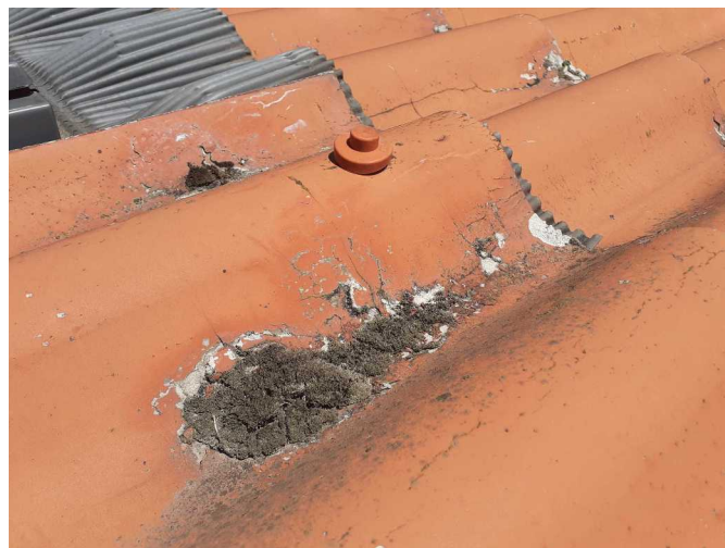
Foto /14/ Degradace střešní vlnité krytiny
