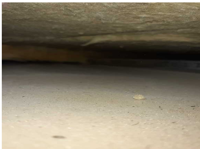
Foto /11/ Vzduchová mezera nad SDK podhledem s parotěsnicí PE fólií
