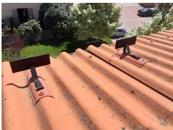
Foto /21/ Sněhové háky na okraji střechy
