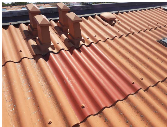
Foto /16/ Již opravovaná vlnitá krytina
