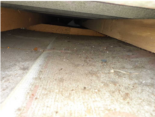
Foto /7/ Povrch pojistné hydroizolace v místě sondy
