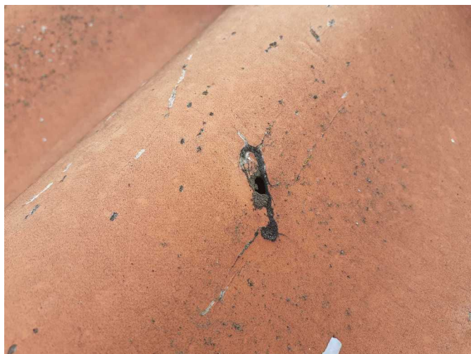
Foto /15/ Degradace střešní vlnité krytiny
