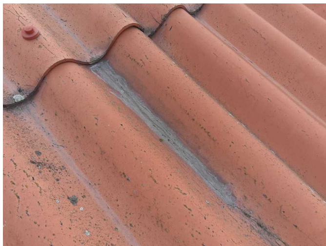
Foto /16/ Degradace střešní vlnité krytiny
