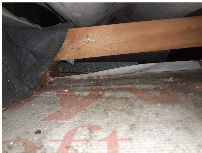
Foto /22/ Pohled podél napojení pojistné hydroizolace na spodní část lemování střešního okna
