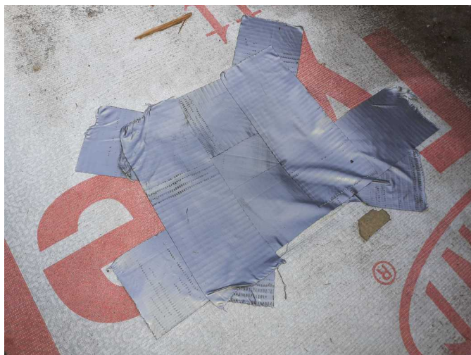
Foto /13/ Zalepení pojistné hydroizolace po provedení sondy
