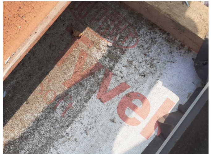
Foto /8/ Povrch pojistné hydroizolace v místě sondy
