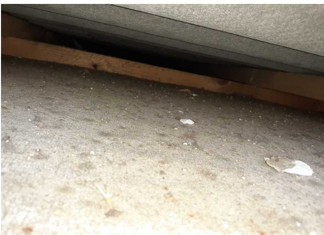
Foto /9/ Povrch pojistné hydroizolace v místě sondy
