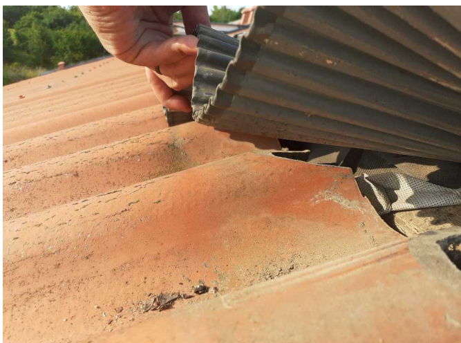
Foto /23/ Pohled pod spodní lemování střešního okna
