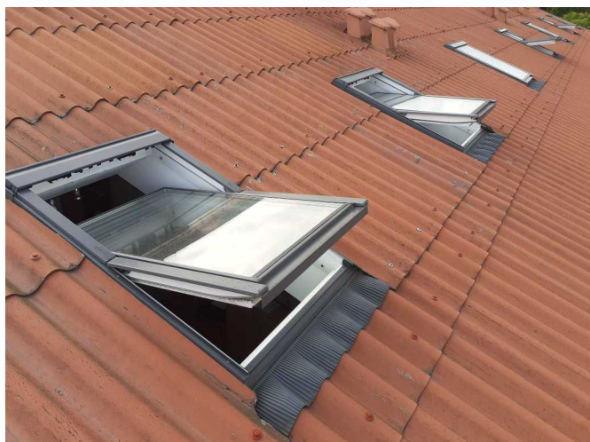
Foto /18/ Střešní kyvná okna
