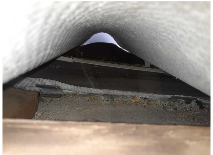
Foto /8/ Napojení pojistné hydroizolace na konstrukci střešního okna
