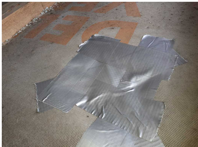
Foto /12/ Zalepení pojistné hydroizolace po provedení sondy
