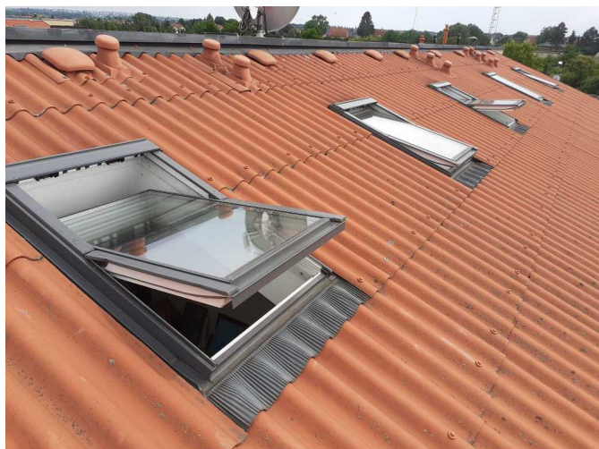
Foto /19/ Střešní kyvná okna
