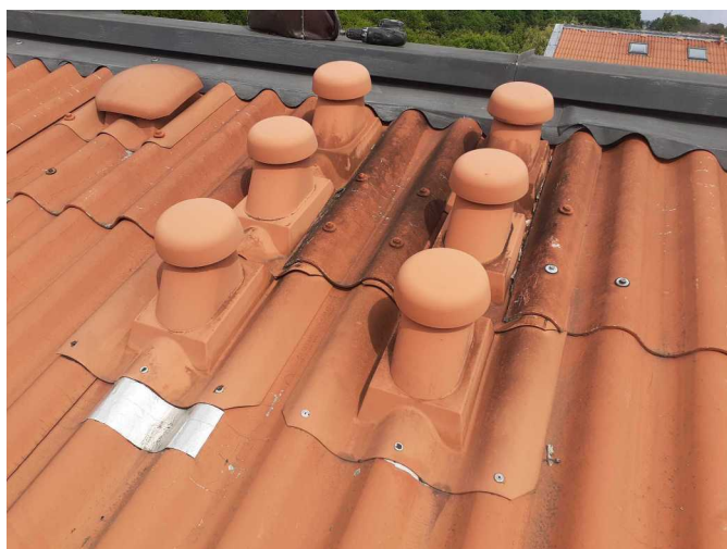
Foto /16/ Komínky odvětrání kanalizace
