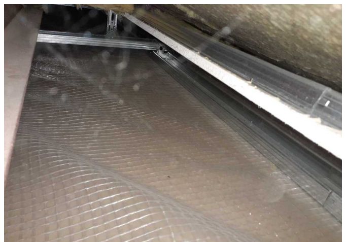
Foto /10/ Vzduchová mezera nad SDK podhledem s parotěsnicí PE fólií
