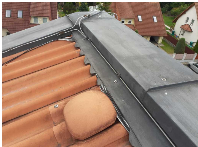
Foto /24/ Vnitřní okraj střechy v oblasti štítu a hřebene
