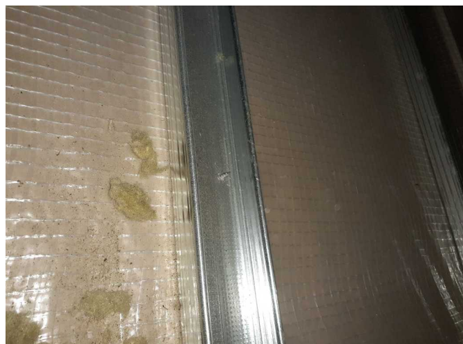
Foto /12/ Vzduchová mezera nad SDK podhledem s parotěsnicí PE fólií
