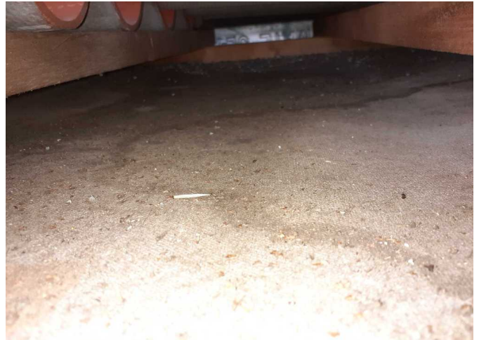
Foto /8/ Stopy po lokálním zatékání na svrchním povrchu pojistné hydroizolace v místě sondy
