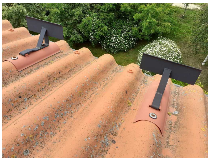
Foto /26/ Sněhové háky na okraji střechy
