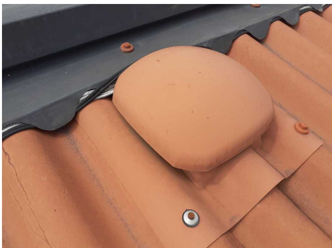
Foto /17/ Jeden z větracích komínků provětrávané vzduchové mezery
